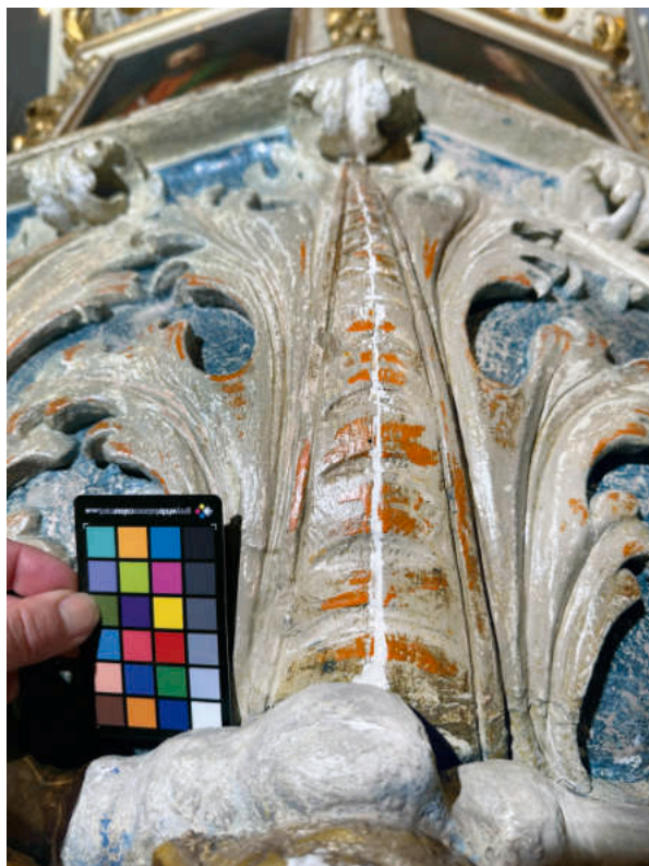
Abb. 6 Nach der Abnahme der Übermalungen ist ein Spannungsriss innerhalb des Akanthusblattes mit Kittmaterialien geschlossen.
